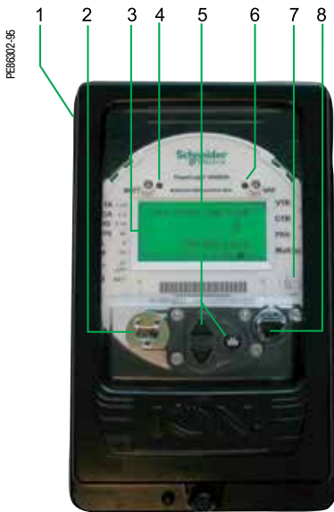
PowerLogic ION8650 в щитке
